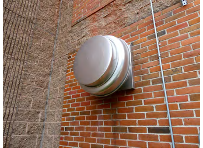
86. MEP - Kitchen exhaust fan
