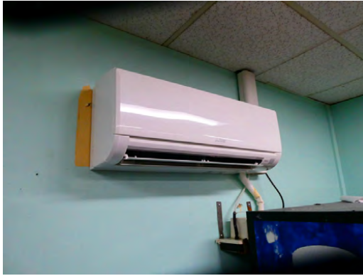
MEP - Mini split system interior AHU
