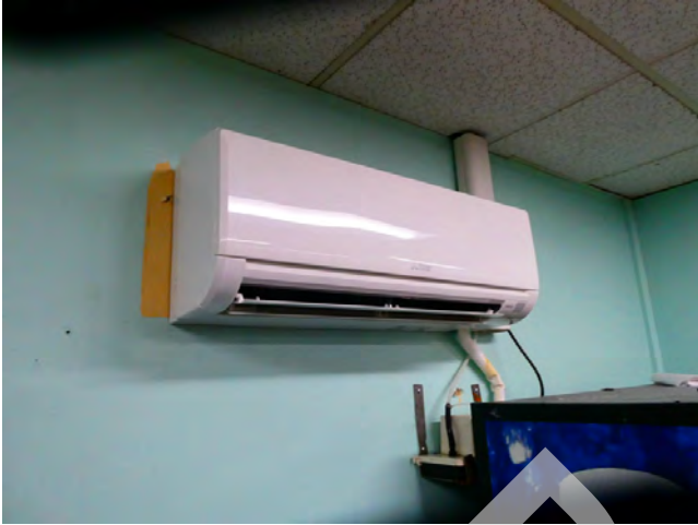
85. MEP - Mini split system interior AHU
