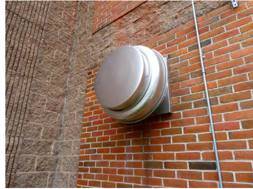
MEP - Kitchen exhaust fan
